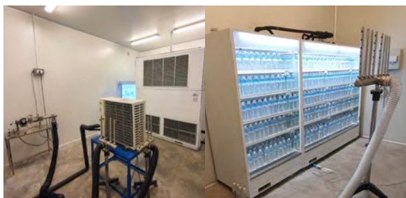
Refrigeration System Lab Testing ห้องทดสอบระบบทำความเย็น
